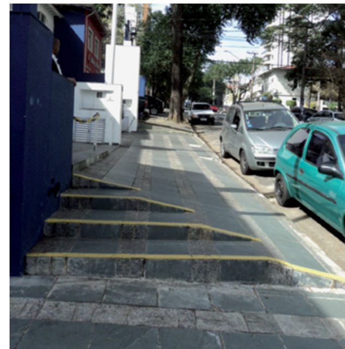
Um exemplo de irregularidade, que além do desconforto, oferece perigo ao pedestre
