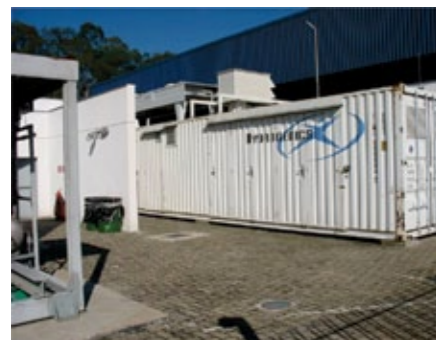
Estação de produção e abastecimento de hidrogênio (em destaque, o eletrolisador, onde o hidrogênio é obtido a partir da eletrólise da água)
