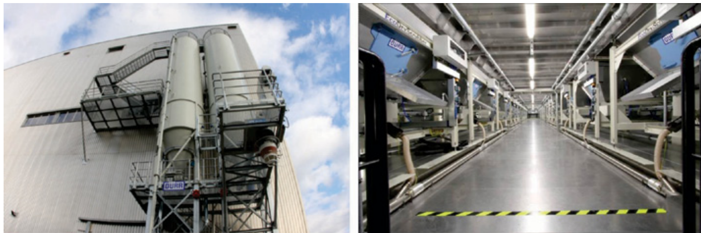
Figura 4 - Limpo e economizador de energia: EcoDryScrubber, um processo livre do uso de água e produtos químicos para a separação de overspray. Esta tecnologia reduz o custo de energia para cabines em até 60%. A imagem à esquerda mostra o abastecimento externo de pó de calcário, a imagem à direita, a área funil
